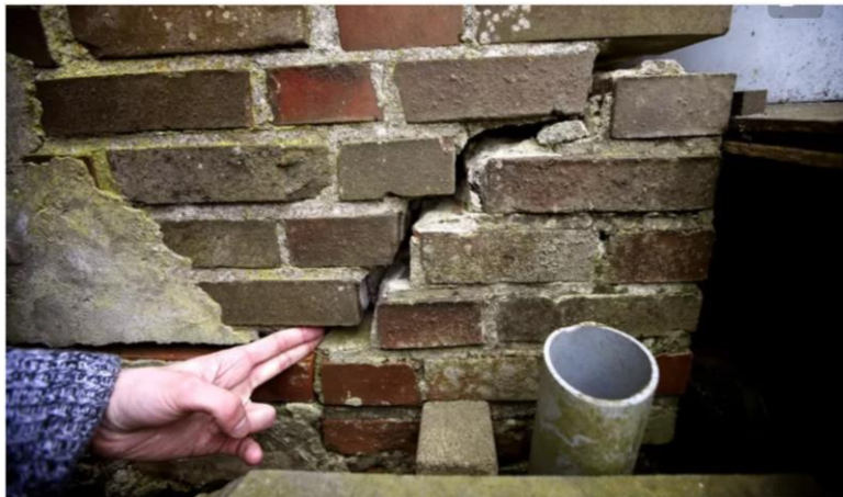
▲ Een scheur in de muur van een woning. Foto ter illustratie. © ANP
